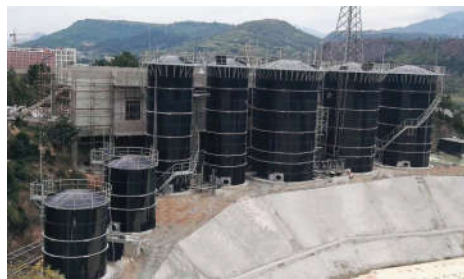
浙江台州垃圾渗滤液处理项目
