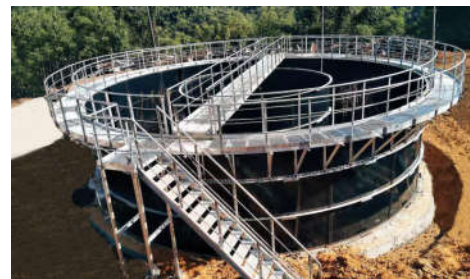
广西梧州乡镇污水处理厂项目
