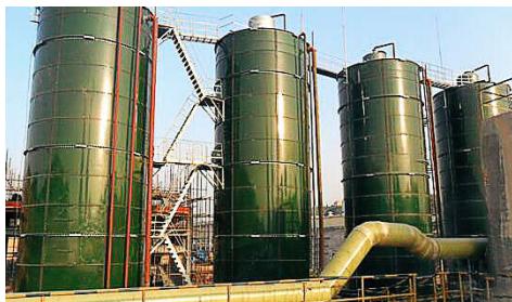
湖北东阳光制药厂污水处理项目
