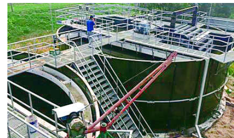
湖南生活污水处理厂项目
